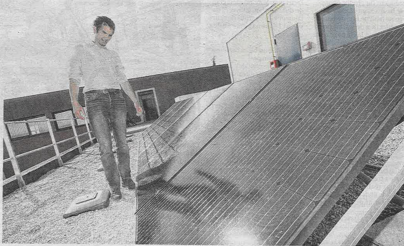
Cofondée par Jérôme Mouterde, DualSun fabrique des panneaux photovoltaïques hybrides à Jujurieux, capables de chauffer aussi un ballon d'eau chaude. Archive Antoine Delsart
